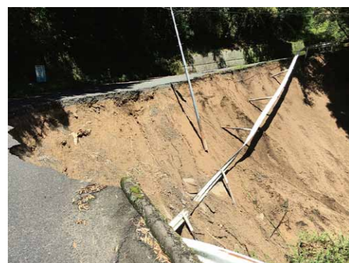
災害直後の、県道から白糸の滝を結ぶ林道
